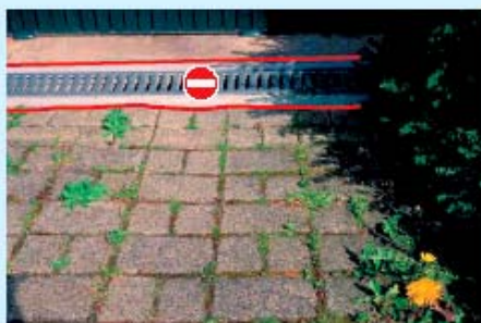
Avaloir au bas d'une pente de garage
