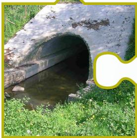
Passage à loutre
